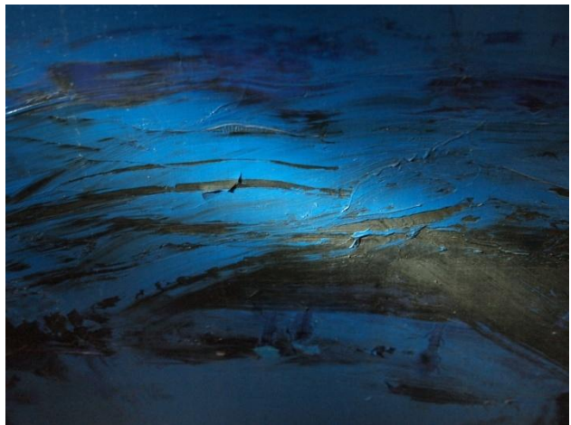
【表・部分】亀裂
