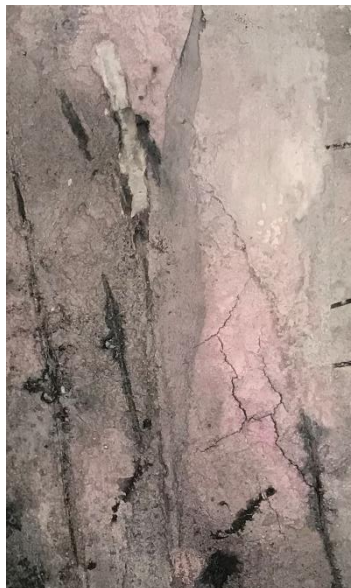
ひび割れ・剥落
